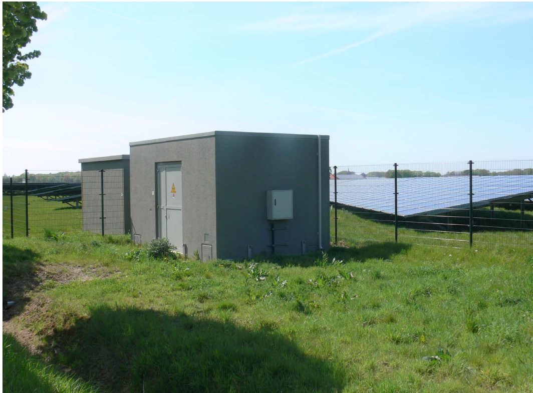
Foto: Wilp - Trafohuisje bij een zonnepark
