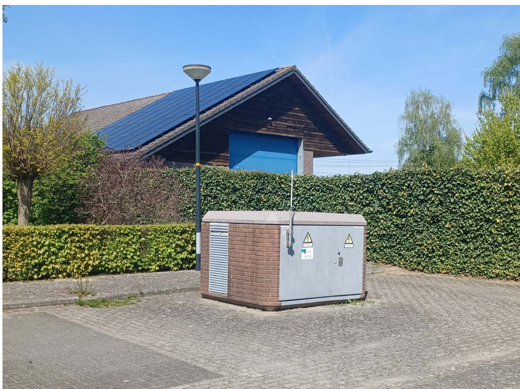
Foto: Twello - Trafohuisje (compact station) op een parkeerplaats
